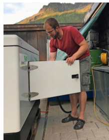
Hüttenwart Thomas Stadelmann füllt beim Notstromaggregat hinter der Hütte den Dieseltank auf.
